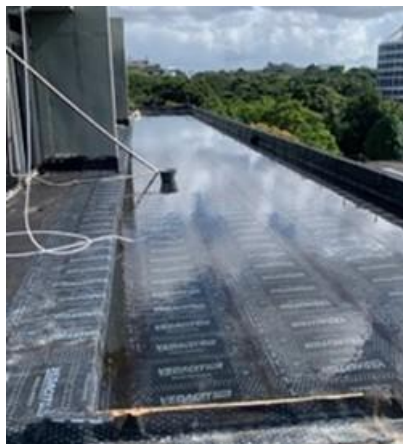
Figura 8: Teste de Estanqueidade
