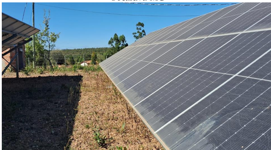
Figura 4 – Empreendimento de produção de energia solar – Chácara José Reinaldo, Bocaiuva-MG
